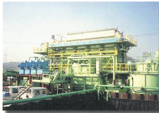
手賀沼浚渫底泥脱水処理 高压薄层フィルタープレス 2,000 × (14m³) × 1台
